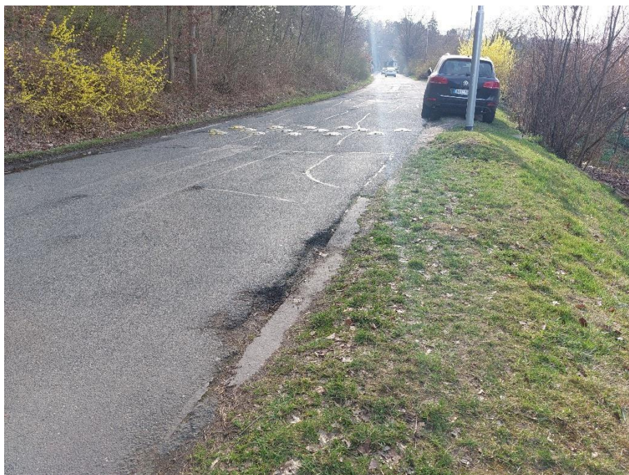
Obrázek 2.17: Okraje vozovky s viditelnými poruchami.
