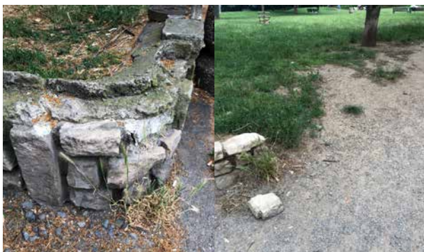
Terénní zídka, drolící se vrstvy, u vstupu z ulice Lotyšská/N. A. Někrasova, přechod různých materiálů a úrovní (zpevněný povrch, trávník, zídka)
