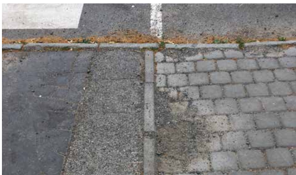
Stav pochozích povrchů – materiálové nesjednocení, relativně opotřebený (foto u vstupu od ulice N. A. Něrasova)
